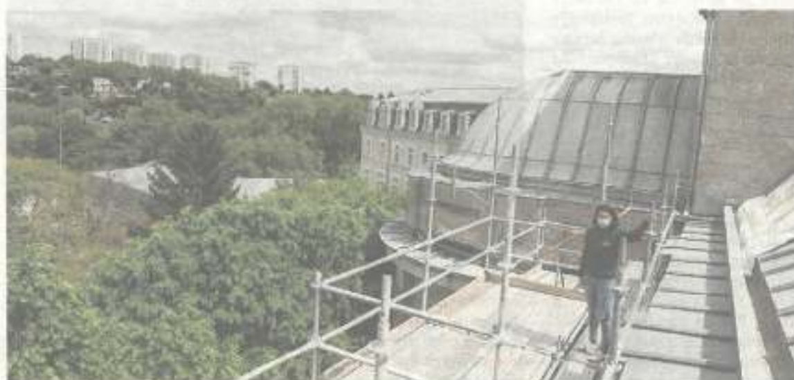
L'association de la chapelle des Feuillants fait appel aux dons pour la restauration de sa toiture. (Photo NR, Mathieu Herdun)
